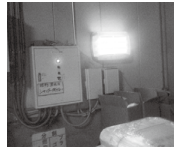
害虫対策：電熱器設置
